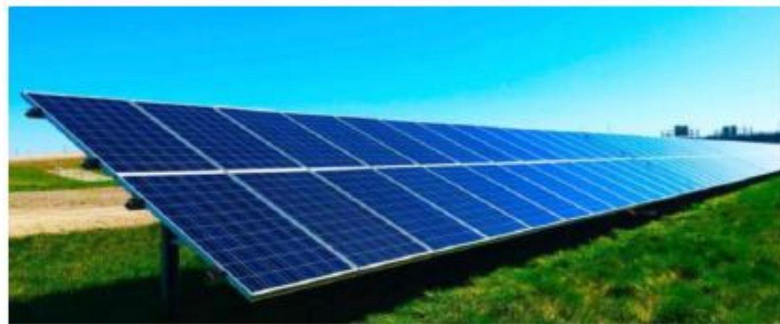
Figure 24 - Exemple de rangée de tables fixes 2V13 portrait d'une centrale photovoltaïque au sol
